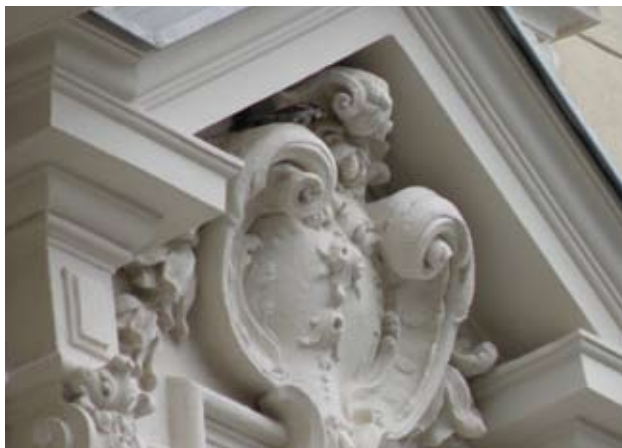
Spatzennest hinter saniertem Stuckelement
