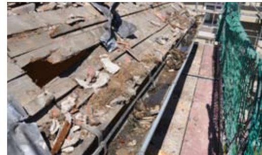
Abgedecktes Dach mit Nistmaterial
